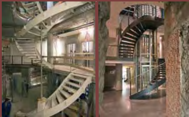
The elegant spiral staircase during construction, and today Die elegante Wendeltreppe im Entstehen und im fertigen Zustand
